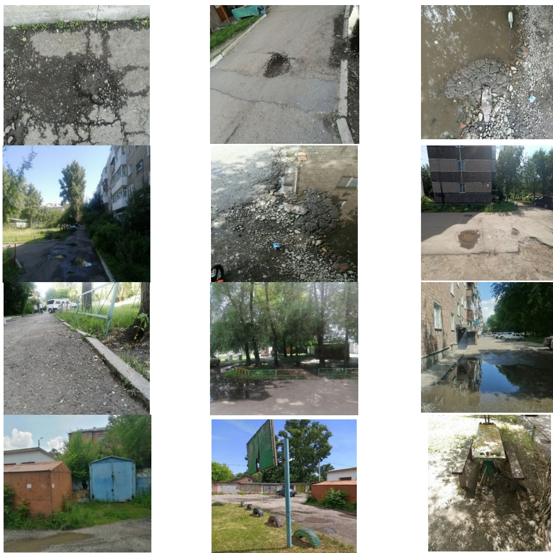
Недостатки дворовых территорий МКД г. Абакана. Фотофиксация
